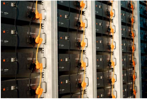
Bis zu 300 einzelne Akkus von E-Autos bilden im Großbatteriespeicher eine Einheit.
